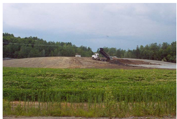
Mise en place de la couche de terre par-dessus la couche peu perméable
